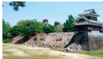
▲本震後の戌亥櫓と東石垣の被害
