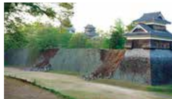
▲前後の戌亥櫓東石垣の被害
