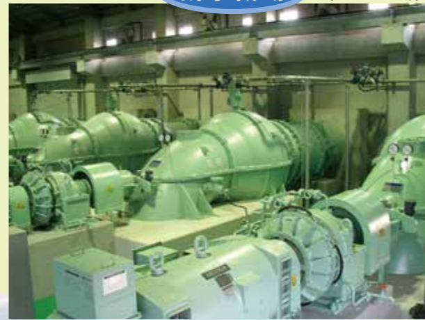
排水機場 (ポンプ場)
