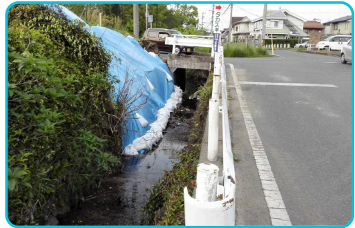
被災した藻器堀川護岸の様子
