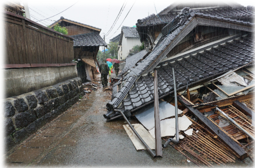
平成28年熊本地震で倒壊した家屋（秋津校区第1町内）
