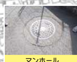
マンホール 洪水時浮き上がる
