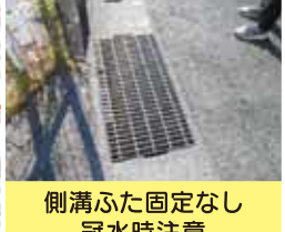
側溝ふた固定なし 冠水時注意
