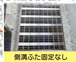
側溝ふた固定なし 冠水時注意
