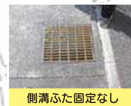
側溝ふた固定なし 冠水時注意
