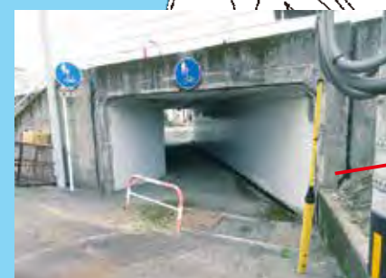
大雨時道路冠水(トンネル)
