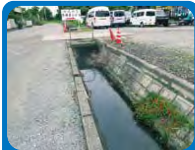
③柵のない水路
