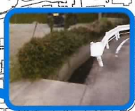
水路に柵がない
