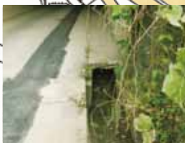
フタの無い側溝 (大雨冠水時歩行注意)
