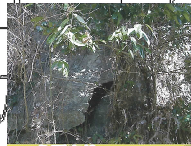
亀裂有り。崩れる可能性有り。
