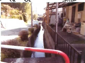
側溝が深いため 大雨時注意
