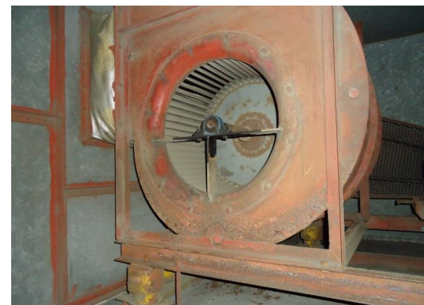
外気ファンの劣化
