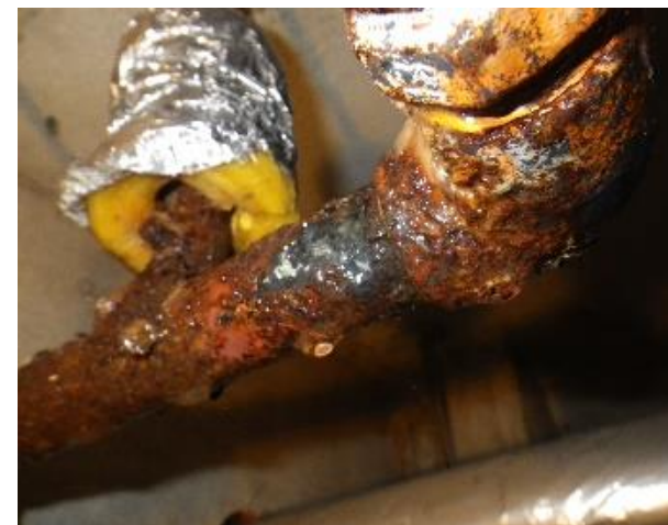
排水管の劣化
