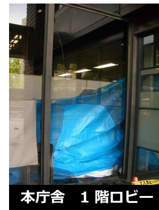
窓ガラスの破損
