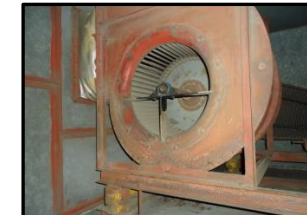
空調用外気ファンの劣化状況 【耐用年数:20年、経過年数:38年】 全体に錆が浮き、異音が発生 (行政棟15階)
