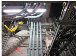
壁面アスベスト吹付状況 「耐火被覆材からクリンタイルが 検出された」 (行政棟1階)
