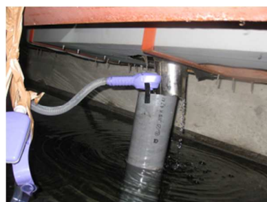
学習ホール天井裏 ずれた雨水配管
