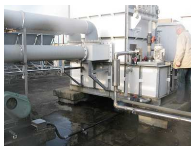
スクラバー 破損
