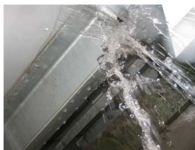
スクラバー 漏水
