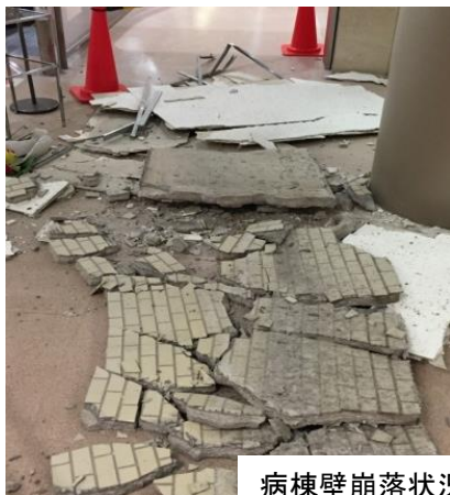
病棟壁崩落状況
