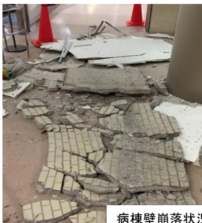
病棟壁崩落状況
