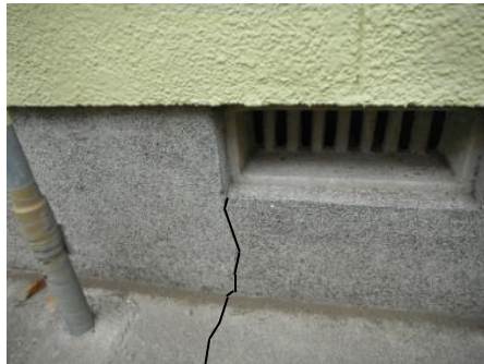
○基礎のクラック
