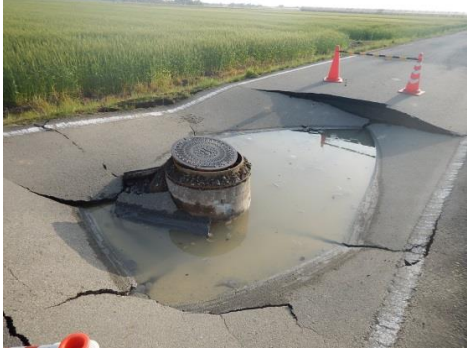
下水道(管路)の被災状況
