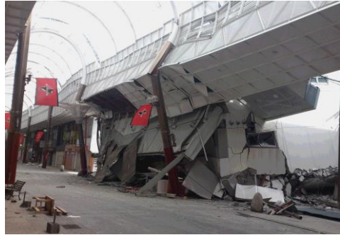
健軍商店街アーケード及び店舗ビルの倒壊
