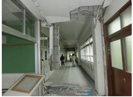
東野中学校の被災状況
