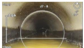
管渠のたるみによる滞水
