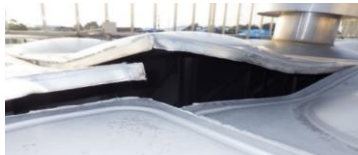
損傷したステンレスパネル
