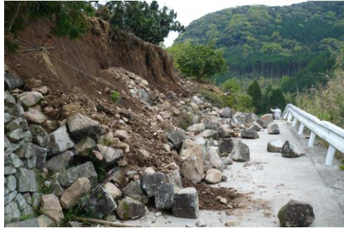
平山地区みかん園地の法面崩落
