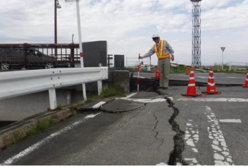
道路と橋梁の段差及び路面の亀裂
