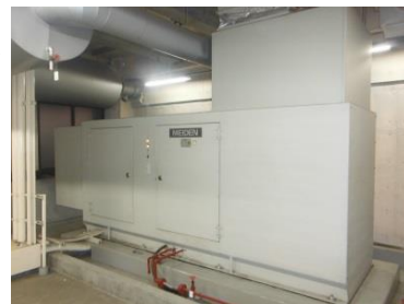
自家発電設備
