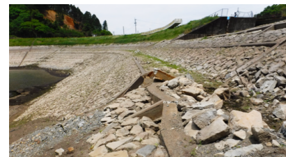
大切畑ため池における法面圧縮崩壊の様子 (株式会社バスコ撮影)
