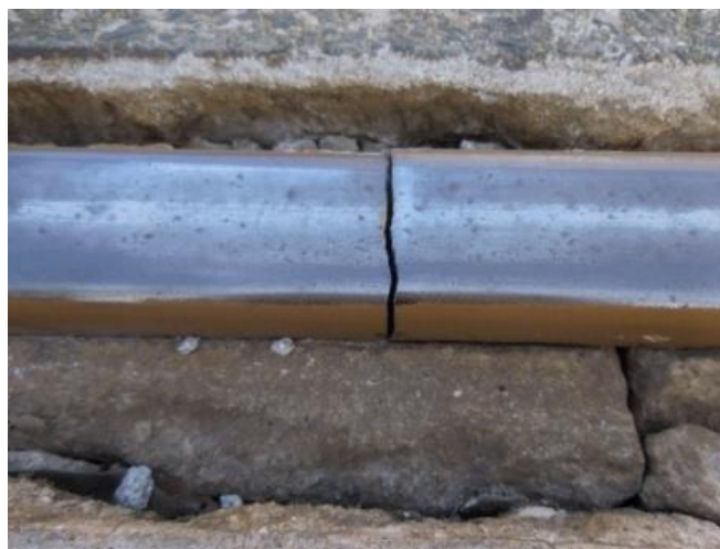
▲ 市電レールの破断
