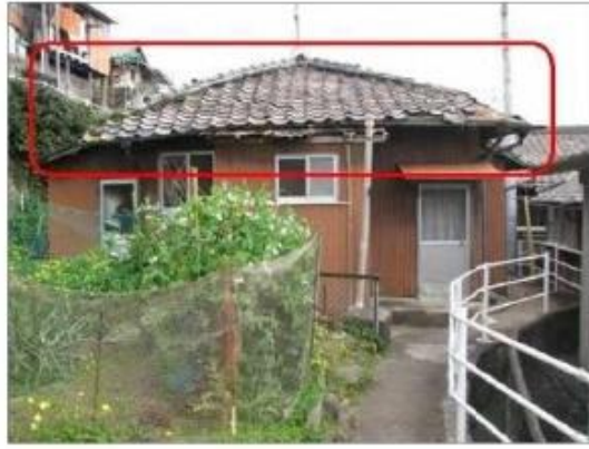
屋根が著しく変形している例
