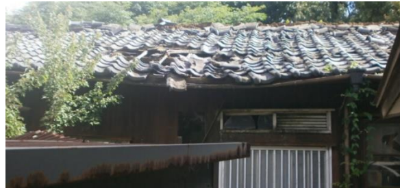
屋根ぶき材に著しい剥落があり、軒が垂れており、屋根全体の変形の予兆がある例
