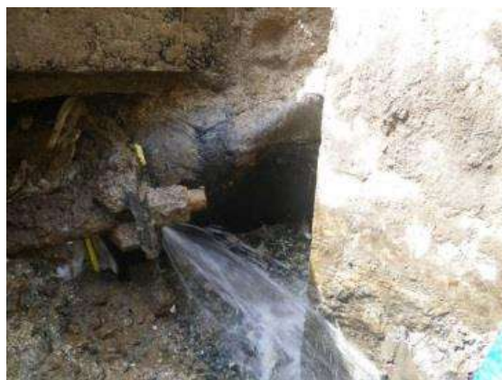
写真 3-8-4-1 熊本地震時における漏水の状況 (沼山津送水管 口径 800mm)
