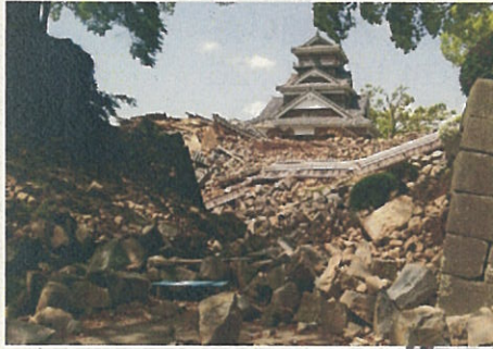
頼当御門内 石垣 ◆石垣崩壊
