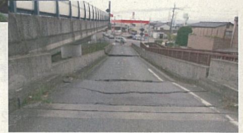
(市) 蓮台寺町第13号線(平田高架橋) ◆架橋横断方向に複数の亀裂
