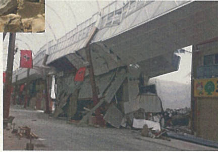
東区健軍商店街 ◆建物倒壊
