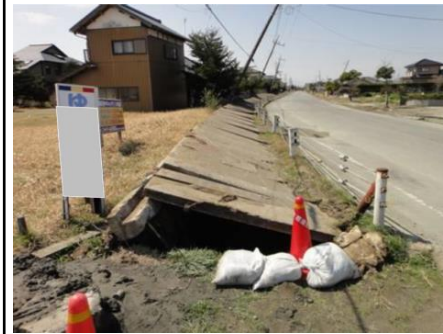
液状化被害状況
