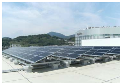
太陽光パネル
