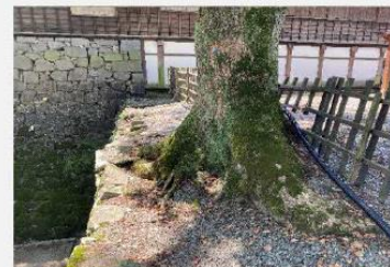
成長し根が石垣を押し出したり変形させる
