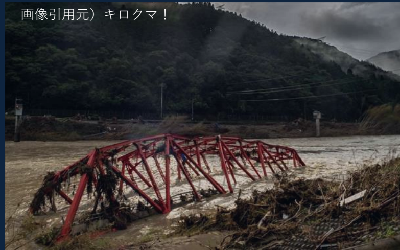
令和2年7月豪雨による県南の被害
