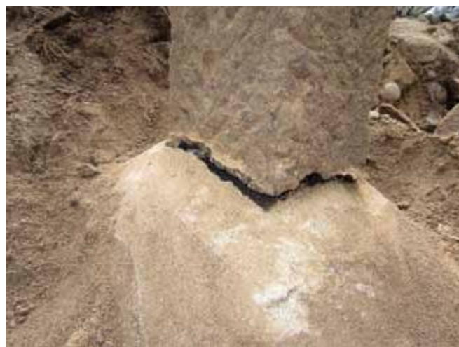
図2 長塀控柱破損状況（平成 22 年 12 月）
