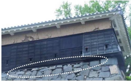
1 北面 石垣天端石の沈下による空隙が生じている。 一部築石に亀裂や割れが認められる。
