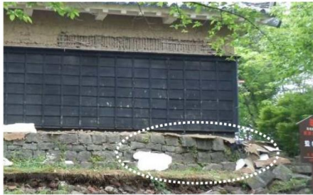
3 南東面① 築石にズレや沈下が見られる。 屋根廻りは大きな被害は見られず、雨漏りはしていない。
