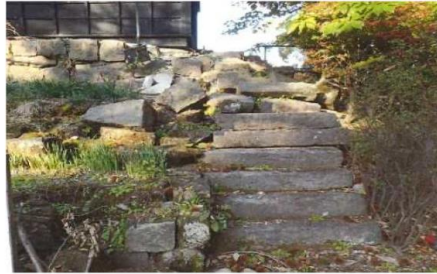
4 南東面②(階段廻り) 軒下にある築石はズレや沈下が見られる。 東端にある階段段石はズレや沈下が大きく見られる。
