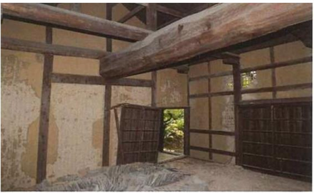
5 内部(右上図⑦通り) 軸部は桁行に対し梁間方向(南側)に大きく傾斜している。 板戸も変形して鴨居までも折損させている。 小屋組・屋根面には大きな被害は見られない。
