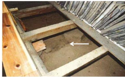
6 内部(床下・右上図⑤通り) 大引下の東石は土間沈下の影響を受け、下がっている。 土間の亀裂は石垣に沿って生じている。(右上図参照)
