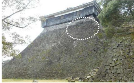
1 北面① 北面西寄りの石垣面に大きな孕み出しが見られる。
