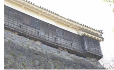
8 〈震災後〉北面③-2(石垣天端部) 天端石が抜け落ち、隙間が生じているのが確認できる。
