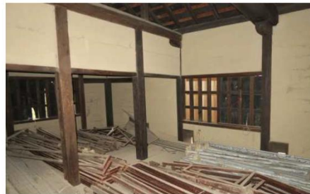
5 内部(西側) 櫓に傾斜(南側へ)が見られる。桁行・梁間方向ともに、土壁に亀裂が生じている。
