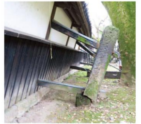
06 堀・控石柱最傾斜箇所(H28.12撮影,H27台風被害箇所)
