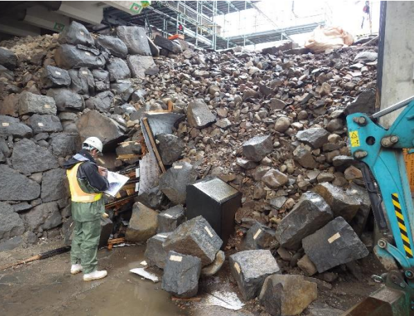
穴蔵西面崩落状況
