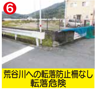
5 荒谷川への転落防止柵なし 転落危険
