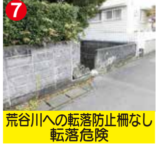
6 荒谷川への転落防止柵なし 転落危険
