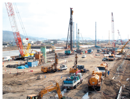
九州新幹線熊本総合車両基地の整備
