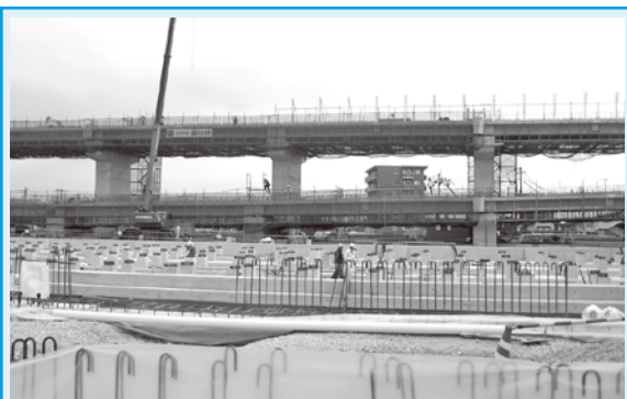
高架橋も着々完成にむけ建設中！ 手前の検車庫は鉄骨の組み立てが始まるのでしょうか？
