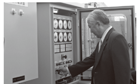
村崎区長により排水ポンプ運転
