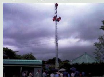
▲河川公園に設置されたサイレン
