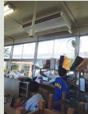
▲技術室(プレハブ)に設置された空調設備
