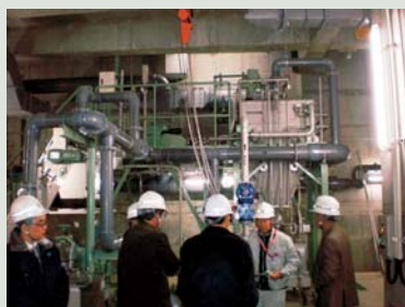
▲中継ポンプ場機械室
