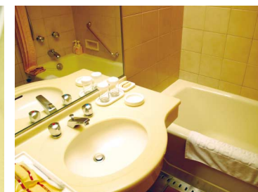
客室のシャワーにも節水コマを設置。使用する前に比べ、約5%の節水ができている
