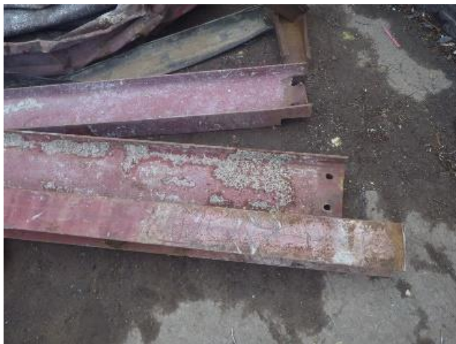
写真 5-2-19 吹付材が付着した鉄骨
