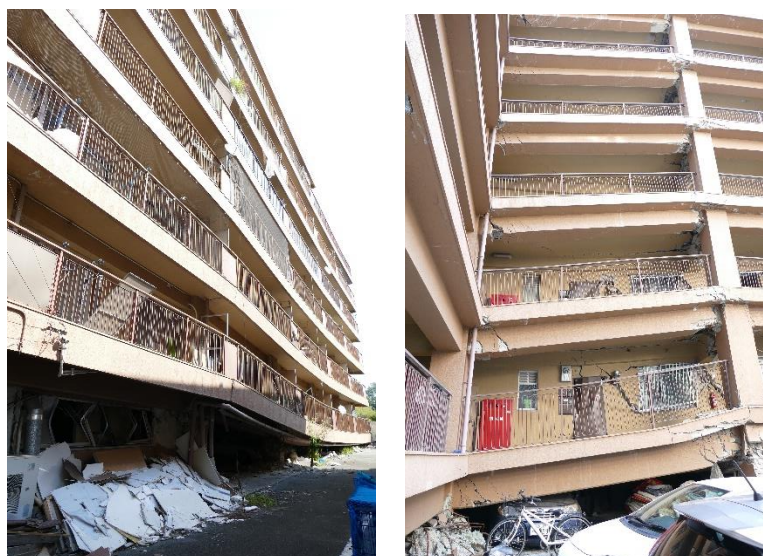
写真 5-2-14 1階部分が座屈したマンション
