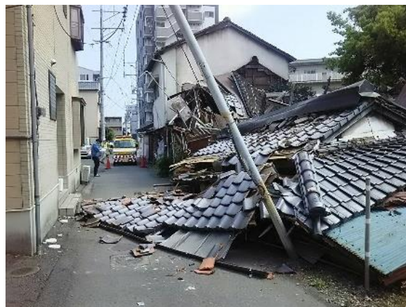
写真 5-2-16 解体着工前に倒壊した家屋
