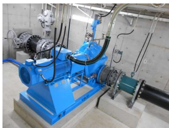
小水力発電 (戸島送水場)
