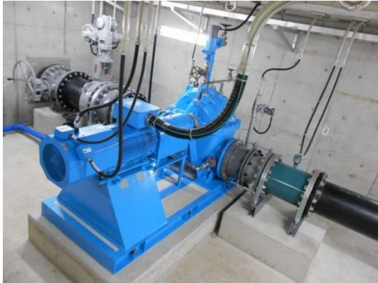
小水力発電（戸島送水場） 出典：熊本市
