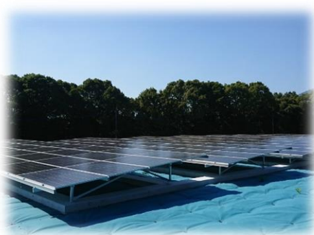
万日山配水池の太陽光発電設備
