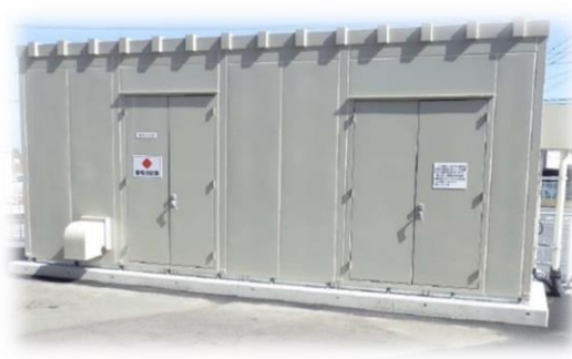
南区役所の大型蓄電池
