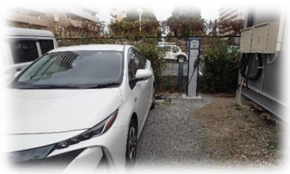
普通充電設備
