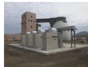
【西部浄化センター消化ガス発電設備】
