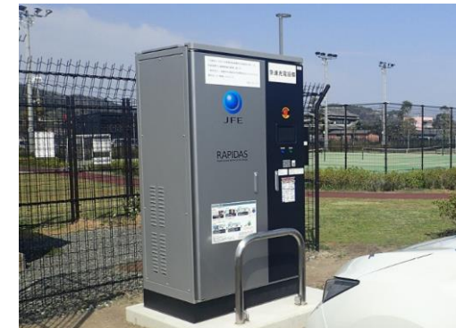
【急速充電設備】
