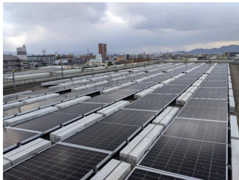
【太陽光発電設備(屋上設置)】
