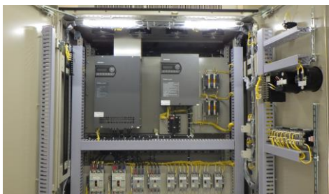
【取水ポンプにおけるインバータ制御の導入】
