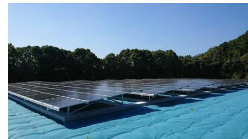
【万日山配水池に導入した太陽光発電】
