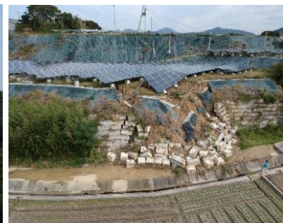
法面保護工が崩れて流出した事例
