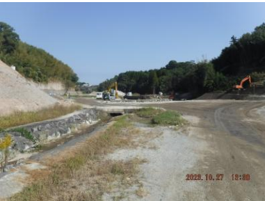
浸透水(処理後)の放流水路
